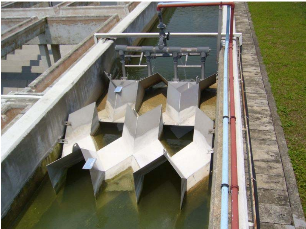
Bild 6: Teil einer Trinkwasseraufbereitungsanlage in einem Wasserwerk in Singapur
