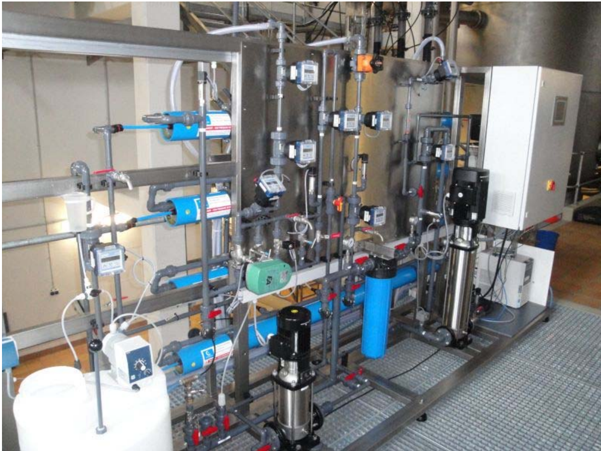
Bild 1: Beispiel einer vollautomatischen und fernsteuerbaren Versuchsanlage aus dem Bestand des TZW mit 8 Membranmodulen in 4 Druckrohren zur Pilotierung der Umkehrosmose für Großanlagen
