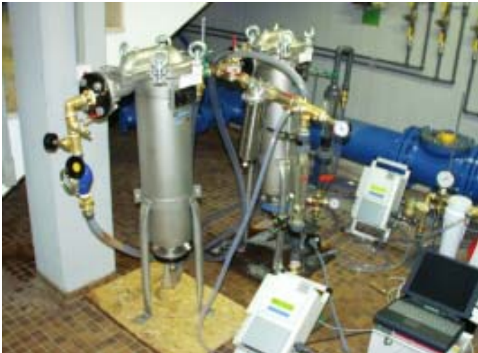
Bild 1: Feinfilterversuchsanlage mit Filterbeutel
