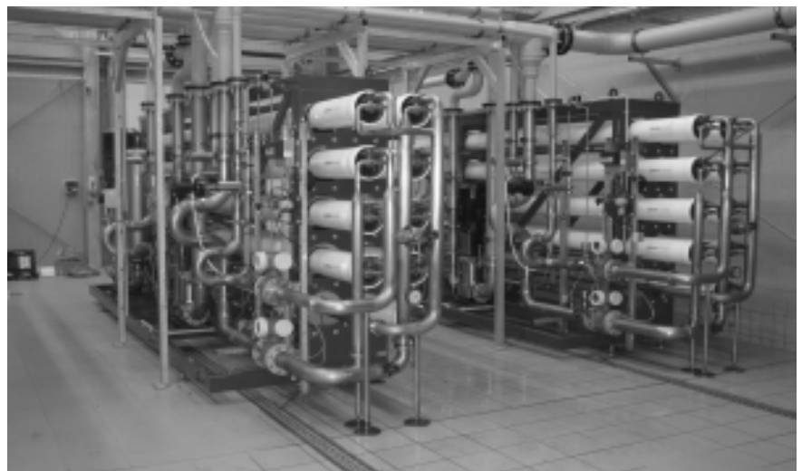
Bild: Ansicht der Großanlage
