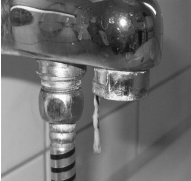
Bild: Wasserhahn mit Schleim
