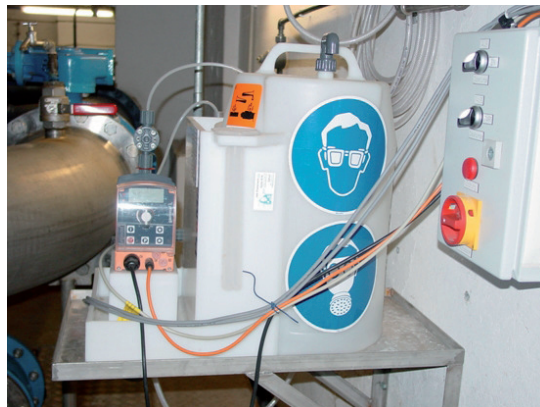
Chlordosieranlage für Notfalldesinfektionsmaßnahmen
