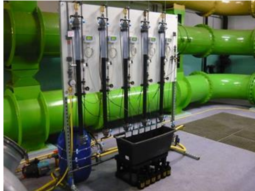
GCS-Teststand im Wasserwerk
