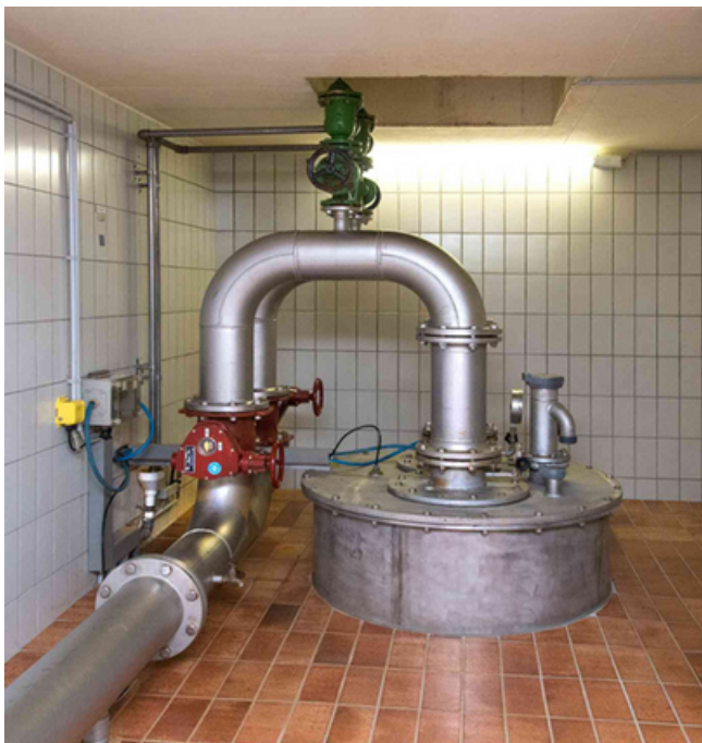
Abbildung 4: Brunnenstube eines Rohwasserbrunnens mit aktivem Entnahmebetrieb.
